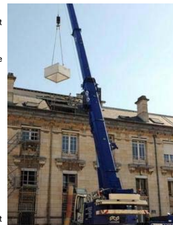
Hier, une grue de levage procédait à la pose d'éléments de béton destinés à une nouvelle cage d'ascenseur. - (Photo NR, Hugues Le Guellec)
